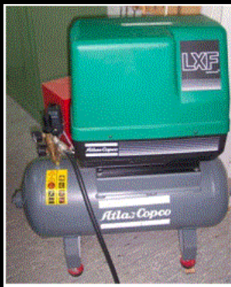
Compressor amb el seu dipòsit
