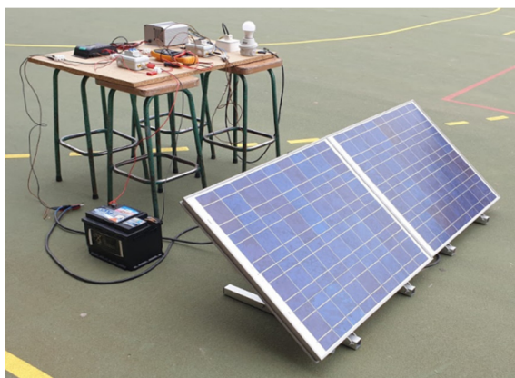
Imatge 9. Plaques fotovoltaïques
