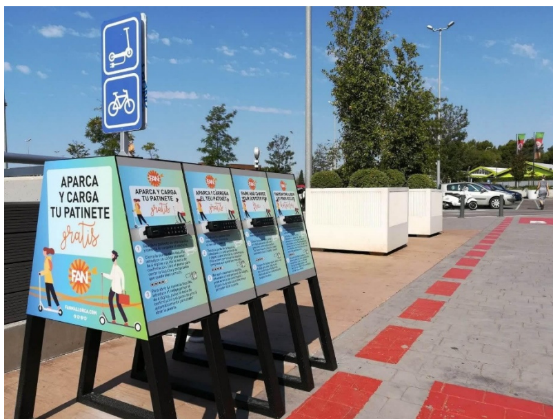
Estación de carga TRAP de YUPCHARGE
